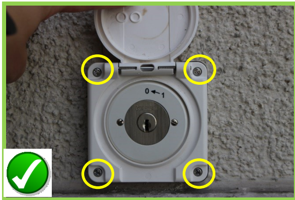
Beispiel Schlüsselschalter der Firma Feller
