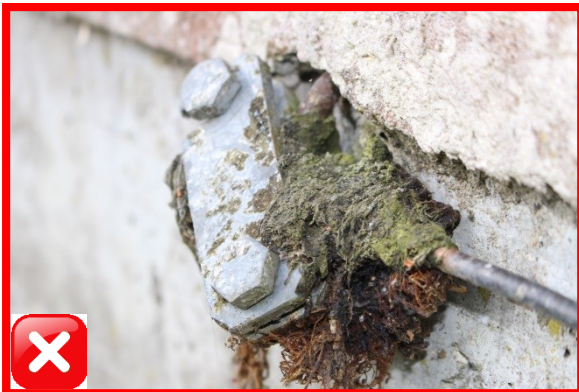
Falsches Material für den Aussenbereich
