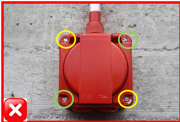
Schlechtes Beispiel: Es wurden nur zwei Sicherheitsschrauben verwendet
