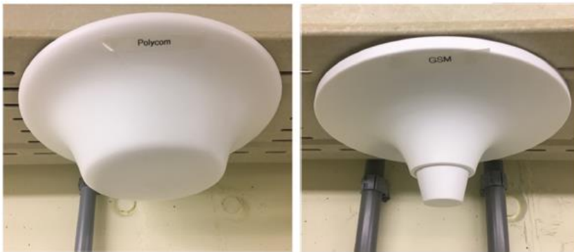
Beispiel einer Polycom-Rundstrahlantenne (links) und einer Rundstrahlantenne für die Mobiltelefonie (rechts)
