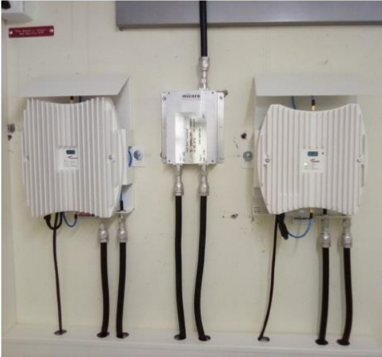
Beispiel eines aktiven Polycom-Breitbandrepeaters (links), eines Duplexers (Mitte) und eines Breitbandrepeaters für die Mobiltelefonie (rechts)
