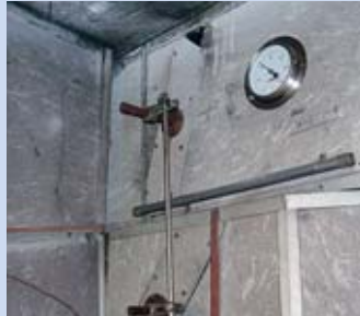
Lüftungsanlage aus Asbestzement
