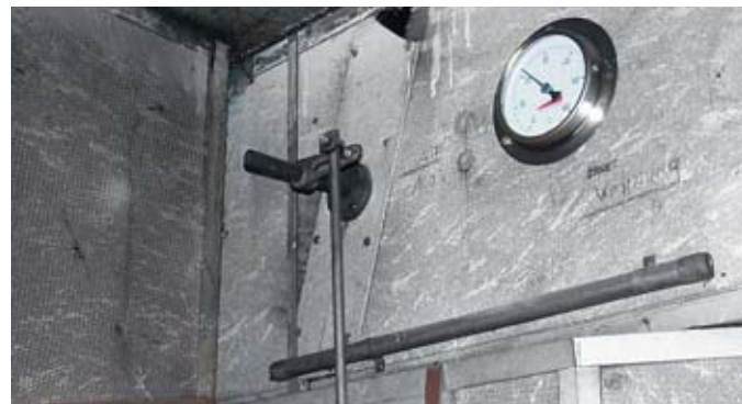
Lüftungskanal aus Asbestzementplatten
