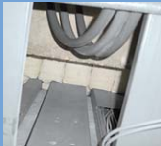
Brandabschottung mit Asbestkissen
