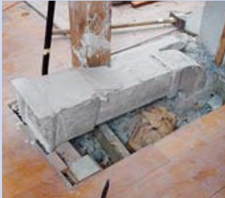
Lüftungskanal aus Asbestzement
