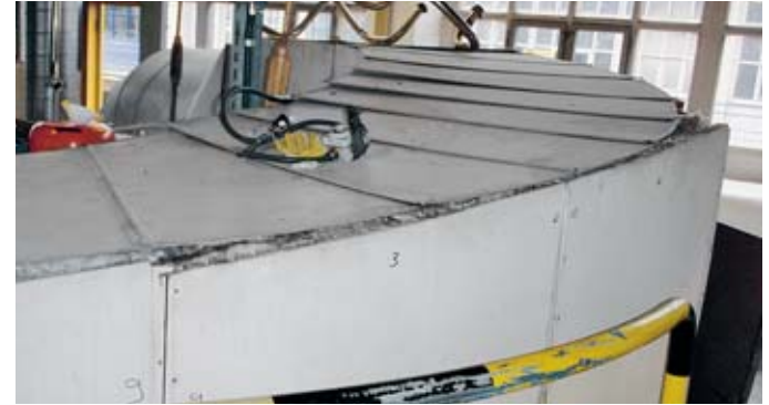
Asbesthaltige Dämmung hinter einer Verkleidung
