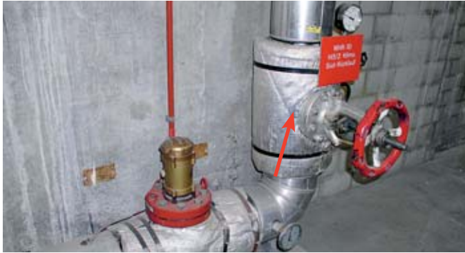
Isolationsschale für die Hitzeisolation
